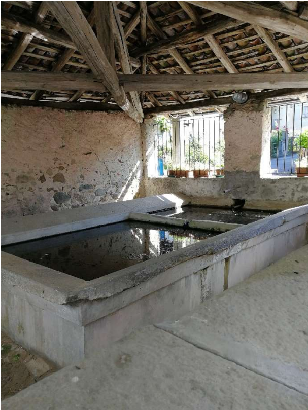
Figura 16: Interno Lavatoio con Vasca in funzionante in sasso e Copertura con travi fessurate e ammalorate.
